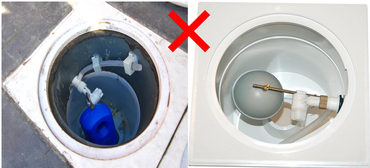
Figuur 8: Niet conforme automatisch bijvulstelsel zwembaden in de skimmer.
